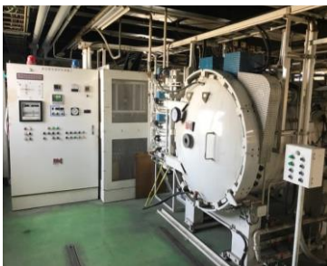
真空熱処理炉（3号炉）
